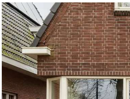
Beperkte gootomloop kopgevel
